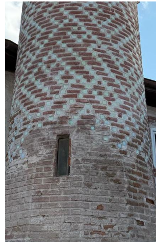
Görsel 5b. Aksaray Yıkık (Kesik) minare detayı.
